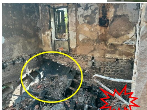
Localisation initiale de la bouteille de gaz en R-1 et reste de plancher
